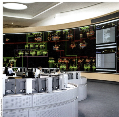
Alles im Blick: In der Netzentwarte in Brauweiler überwacht Amprion das Übertragungsnetz – unterstützt durch Softwarelösungen von Soptim.
